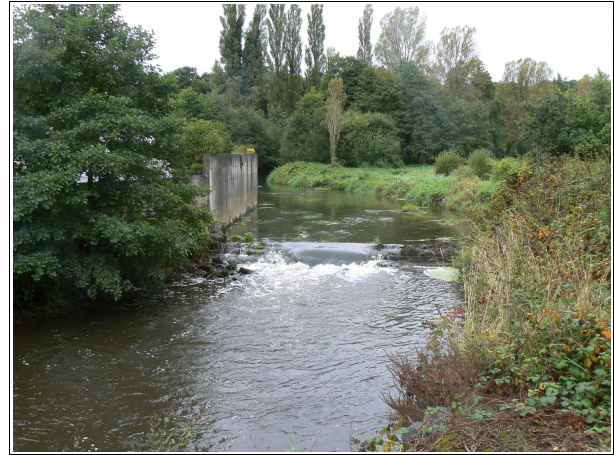
Photo 04 - Seuil détruit après les événements de 1995
